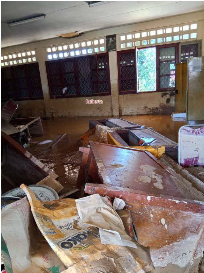
Von Schlamm-Massen zerstörte Schulräume
